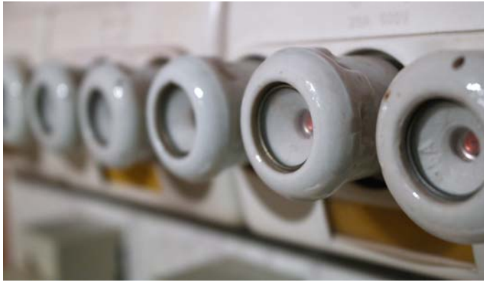
... Sicherungen einer Verteilung...
